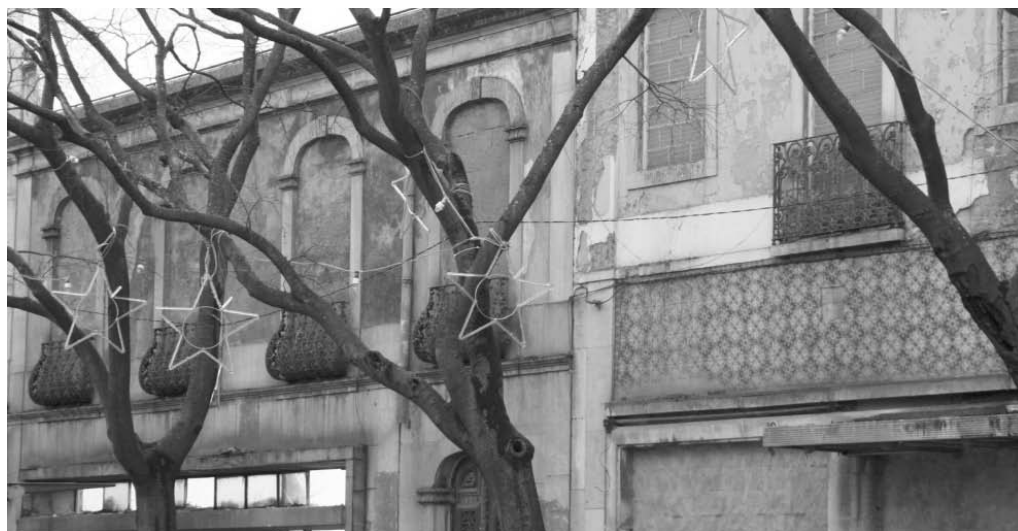
Fotografia 5 — Prédios devolutos e em estado de ruína (DGT, 2013)
